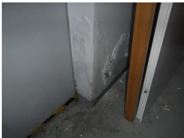
Kuva 7.6; kosteuden aiheuttamia vaurioita puukoulun kellarissa. Maali hilseilee kosteuden takia irti lattiosta sekä seinien alaosista.
