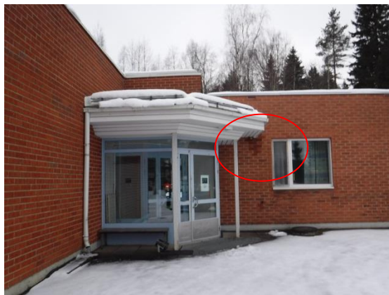
Kuva 9.8; Myös pajarakennuksen ulkoseinissä on näkyviä kastuneita paikkoja.
