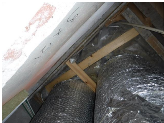
Kuva 10.3; Yläpohjan "höyrinsulku" on asennettu paikoin epätiiviisti.
