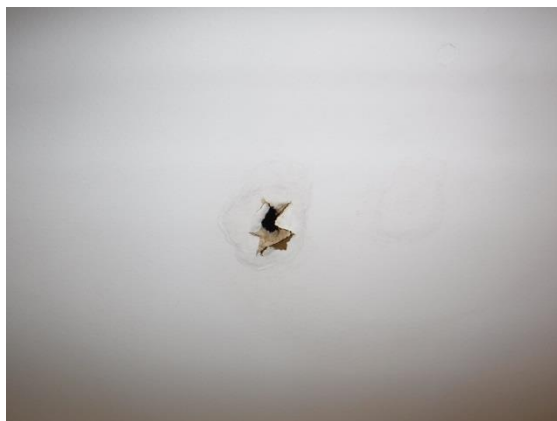
Kuvat 10.4; pukuhuoneen wc:n katon kosteusjälki.
