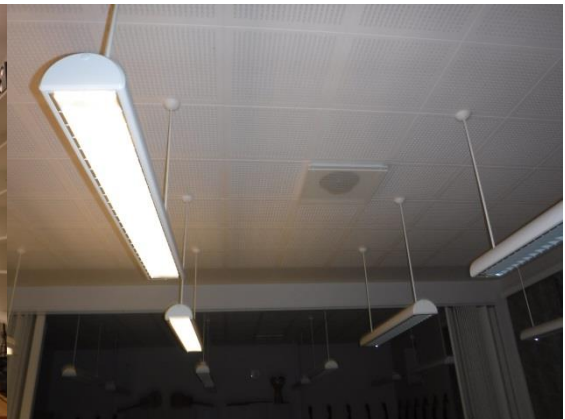
Kuva 11.2; Tuloilmavaihto puhalttaa yläpölyt valaisimien päältä.
