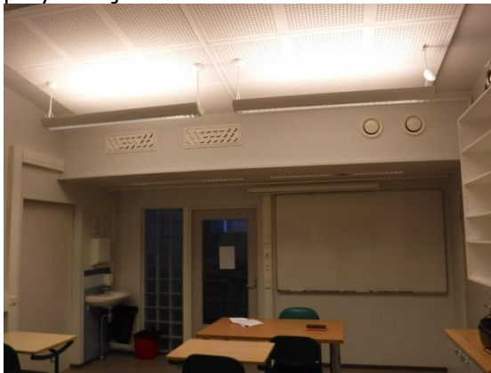
Kuva 11.1; Tulo- ja poistoventtiilit on paikoin lähellä toisiaan.
