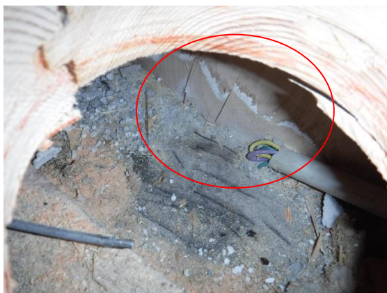
Kuva 8.8; Auditorion varaston lattia avaus. Vaneripinnoissa näkyy kosteuden aiheuttamia jälkiä. Mineraalivilla lankkulattian alla todettiin mikrobivaurioituneeksi.
