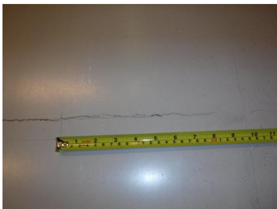
Kuva 8.9; Kirjaston lattiassa 25 x 25 laatta, sisältää asbestia. Rikkinäisistä laatoista voi irrota asbestipölyä sisätiloihin.
