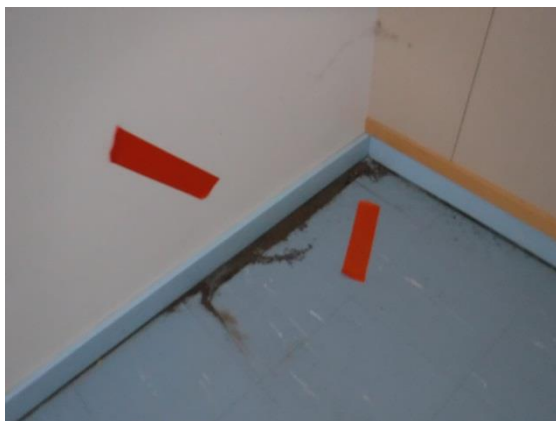
Kuva 8.10; Kansalaisopiston tilojen lattia on painunut. Lattian ja seinän liittymästä kulkeutuu sisälle hiekkää, jota oli kaapin taakse kertynyt huomattava määrä. Huom! Asbestilaatta
