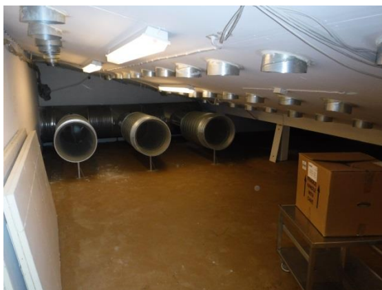
Kuva 11.7; auditorioon johdetaan ilma kammion kautta, jossa on näkyvää pölyä ja epäpuhtauksia. Tilan puhtauteen tulee kiinnittää huomiota.
