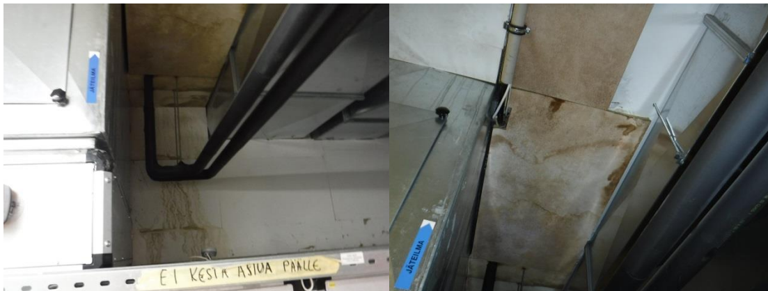
Kuvat 11.5 ja 11.6; Lukion iv-konehuoneessa oleva vanha valumajälki. Vaurioituneet levyt tulee poistaa.
