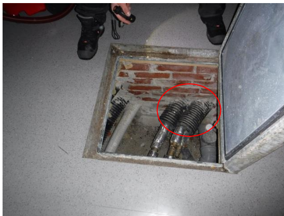
Kuva 8.3; Rehtorin huoneen viereisen käytävän putkikanaalin luukku. Lämpöjohdot kääntyvät biologian luokkien edessä kulkevaan käytävään, jonka lattia todettiin märeksi.
