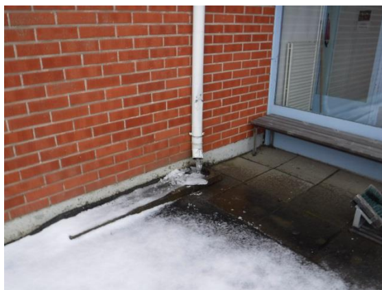
Kuva 6.3; kansalaisopiston tilojen sisäänkäynnin vieressä sadevedet ohjataan sokkelin viereen. Tämä lisää perustusten kosteusrasitusta.
