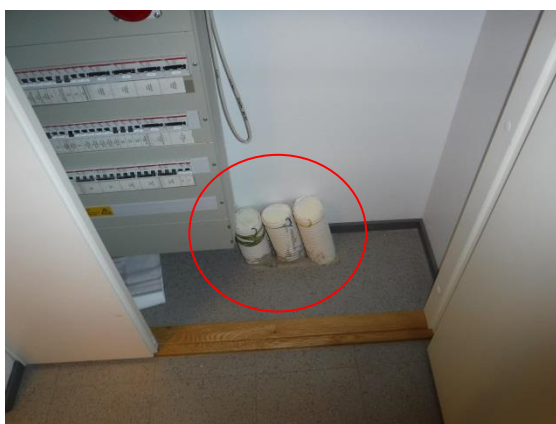
Kuva 8.6; Liikuntasalin takana olevan sähkökaapin epätiivittä läpivientejä. Kaapissa aistittiin voimakas maakellarin haju.
