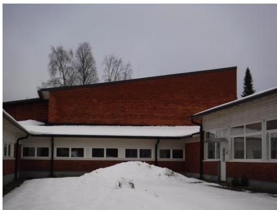
Kuva 9.1, Tiilivuoratut ulkoseinät ovat silminnähtävien kastuneita. Räystäättömyys pahentaa ongelmaa. Tuulenpaineesta johtuen viistosade nousee kastelemaan usein seinärakenteen yläosan.
