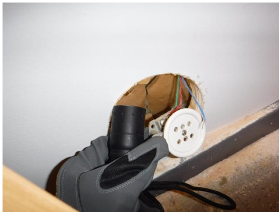
Kuva 9.4; Valvomo tilan seinälevytyksen takaa löydettiin vanha puhelinpistoke.
