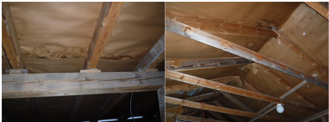
Kuvat 10.1 ja 10.2; aluspaperissa näkyy vanhoja vuotojälkiä. Katselmushetkellä näkyvästi kosteita paikkoja ei havaittu.
