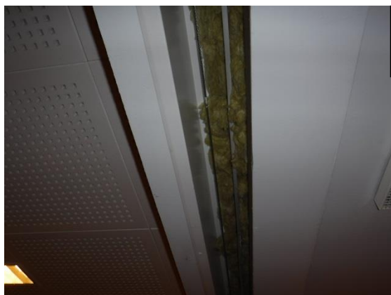
Kuva 10.6; Palo-oven ympärillä on villapintoja. Villat on syytä poistaa.
