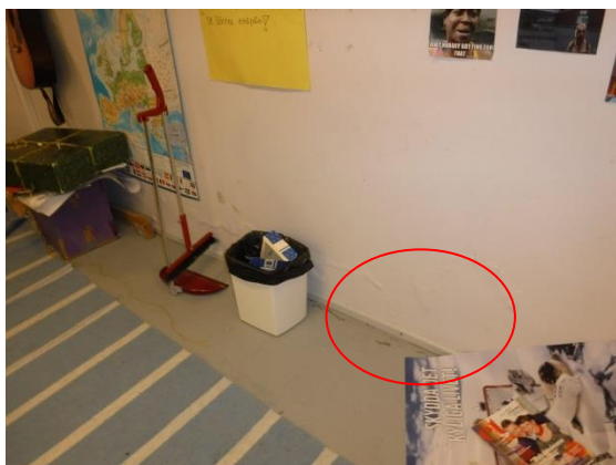
Kuva 8.1; oppilaskunnan tilan seinä ja lattiapinnoilla olevia kosteuden aiheuttamia vaurioita.
