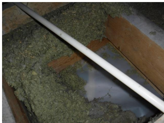
Kuva 10.7; Yläpohjassa paikallinen eristämätön kohta.
