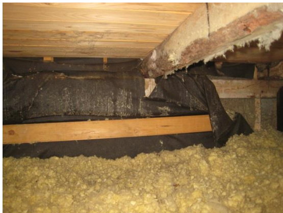
Kuvat 10.8; Lukion yläpohja, tuuletus puutteellinen.
