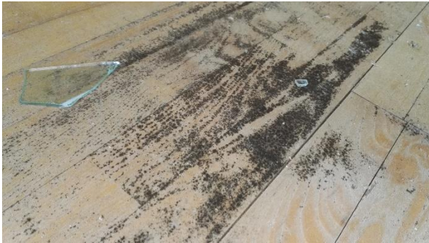
Kuva 10. 2. kerroksen huoneiston 4 puulattiassa selvää mikrobikasvustoa.
