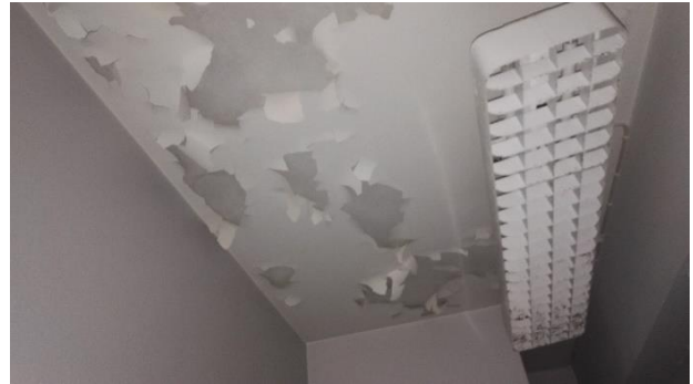
Kuva 35. Maali irtoaa betonisesta katosta.
