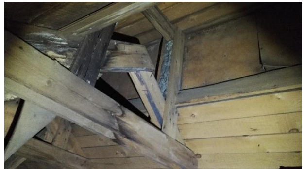
Kuva 21. Osa puurakenteista oli huonokuntoisia.
