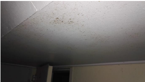
Kuva 36. Silmin havaittavaa mikrobikasvustoa kellarin katossa.
