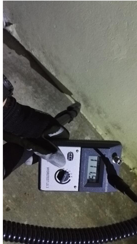
Kuva 13. Kosteuspoikkeamaa kantavan seinän vieressä.
