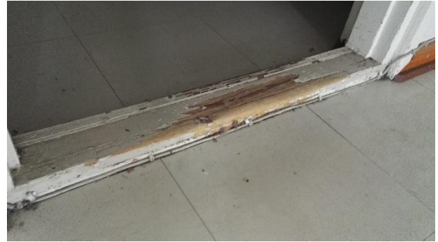
Kuva 31. Väliovien kynnykset ovat paikoin huonossa kunnossa.
