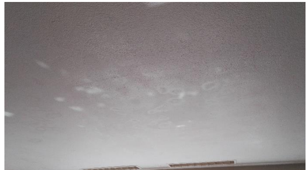
Kuva 37. 2-kerroksen katto ”kukkii”
