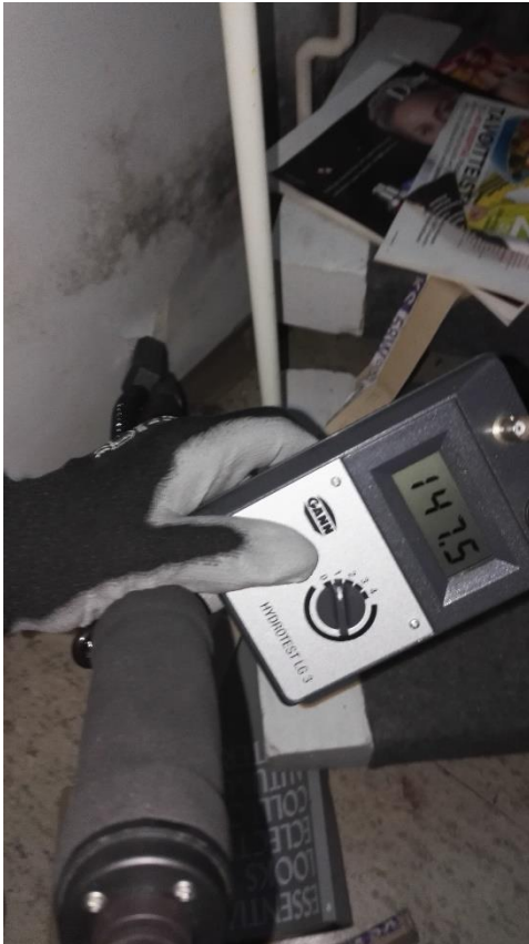
Kuva 12. Kantavassa seinässä havaittiin pintavauriota pintamateriaalissa. Seinän kohdalla havaittiin poikkeavaa kosteutta pintakosteusilmaisimella.
