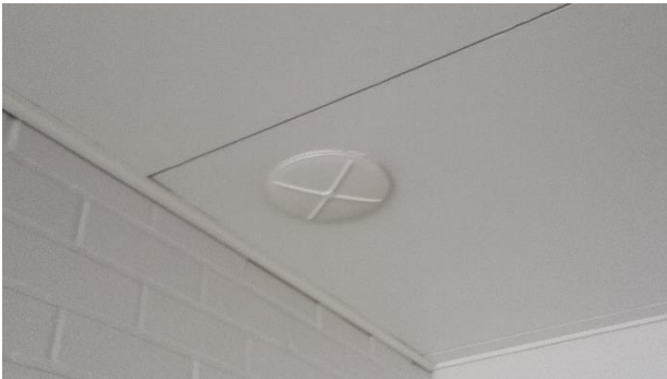
Kuva 40. Poistoilmaventtiili entisen matkatoimiston tiloissa.
