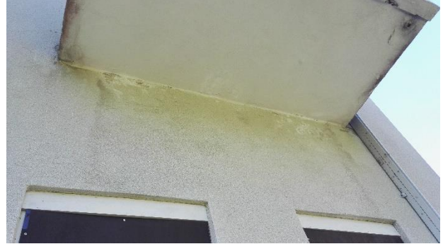
Kuva 29. Ulkoseinässä sekä parvekkeessa tummentumia.
