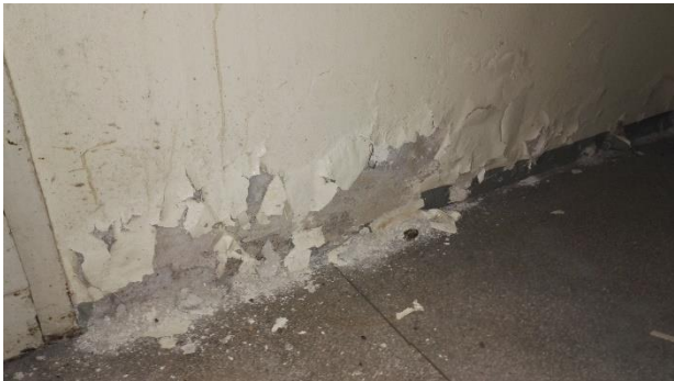
Kuva 5. Kosteudesta aiheutunutta maalipinnan hilseilyä.
