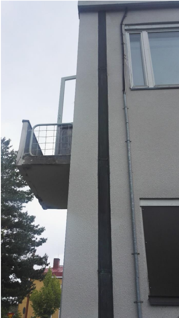
Kuva 4. Syöksytorvet on upotettu ulkoseinään. Parvekkeen alapuolinen betoni on rapistunut.
