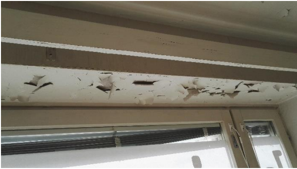
Kuva 32. Maalipinta rapissut ikkunan päältä.
