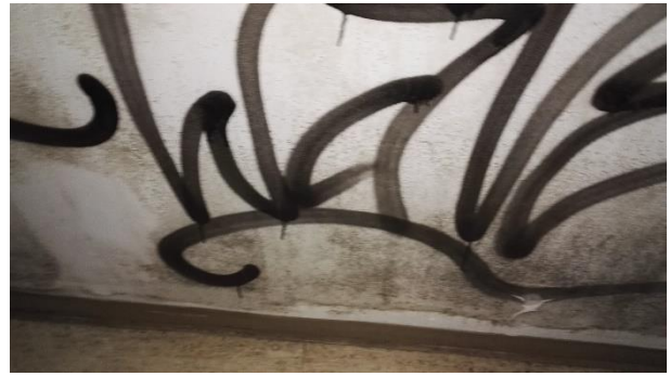
Kuva 6. Maanvastaisen seinän alaosassa näkyvää mikrobikasvustoa.
