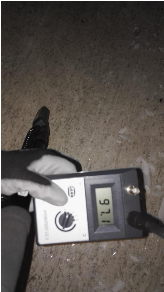
Kuva 8. Alapohjassa todettiin koholla olevia kosteuksia pintakosteusmittarilla.
