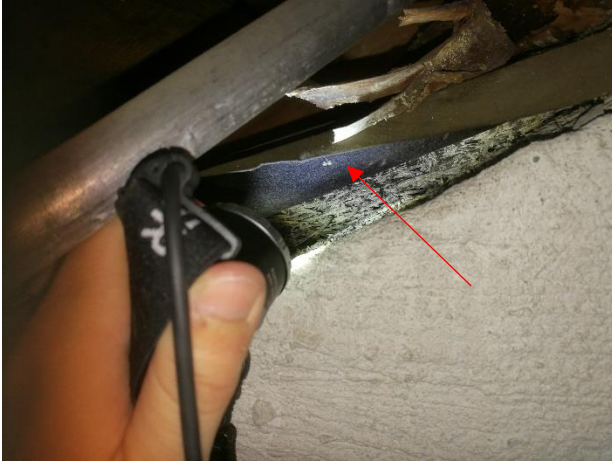
Kuva 9.1 Yläpohjan tervapaperin PAH-pitoisuus ei ylitä vaarallisen jätteen raja-arvoa.
