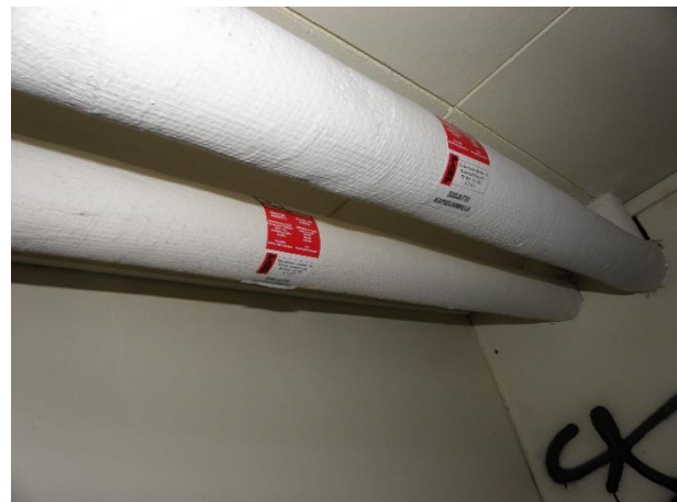
Kuva 4.4 Kellarikerroksen massaputkieristeet sisältävät asbestia.
