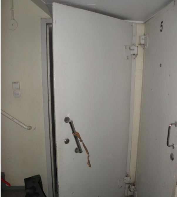
Kuva 4.5 Vanhat palo-ovet karmirakenteineen sisältävät tyypillisesti asbestia.
