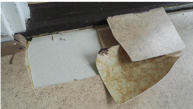
Kuva 8.7 2.krs huoneisto 3, keittiö, alemman ja päällimmäisen muovimaton raskasmetallipitoisuudet ylittävät haitallisen jätteen ylemmän ohjearvon.
