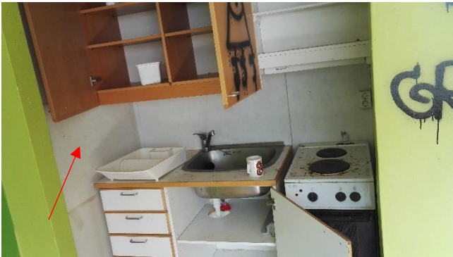
Kuva 8.5 2.krs huoneisto 4, keittiön seinän muovitapetti, raskasmetallipitoisuudet ylittävät haitallisen jätteen ylemmän ohjearvon.
