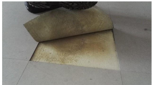
Kuva 8.8. 1.krs matkatoimisto, harmaa Finnflex, raskasmetallipitoisuudet ylittävät haitallisen jätteen ylemmän ohjearvon.
