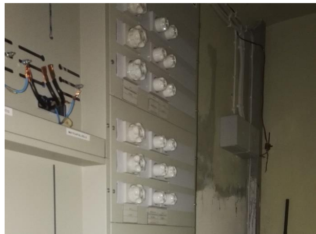
Kuva 11.2 Sähkö- ja muuntamolaitteissa voi olla vaarallisia yhdisteitä sisältäviä nesteitä tai komponentteja.
