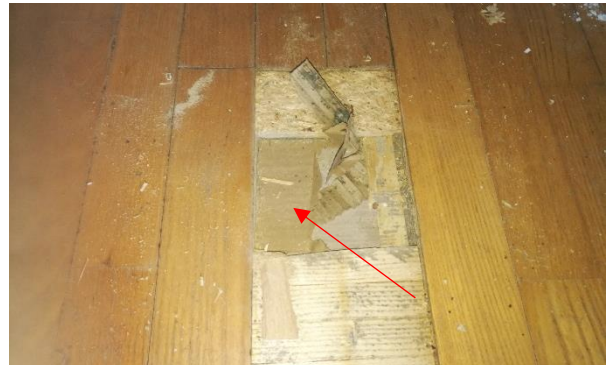
Kuva 8.6 2.krs huoneisto 4, muovimatto parketin alta, raskasmetallipitoisuudet ylittävät haitallisen jätteen ylemmän ohjearvon.
