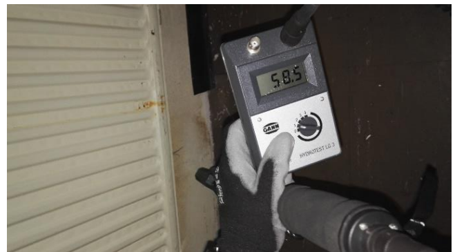
Kuva 4.2 Arkiston ruskea Finnflex-laatta ja putkieristeet sisältävät asbestia.
